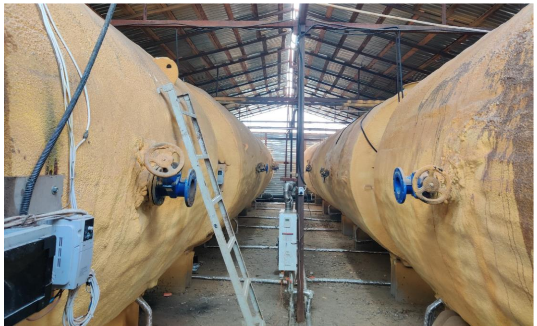
Рисунок 1.18 - Общий вид биогазовой установки.
